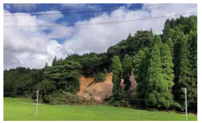
土砂崩れが起きた唐津市の山間部
