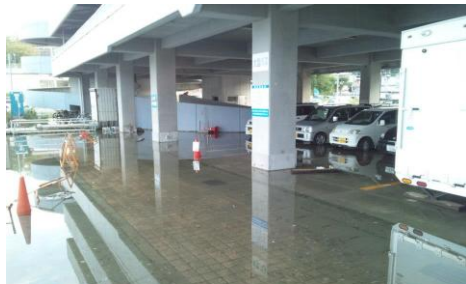
地盤沈下により満潮時に浸水する地域も (2012年10月宮城県気仙沼エースポート)
